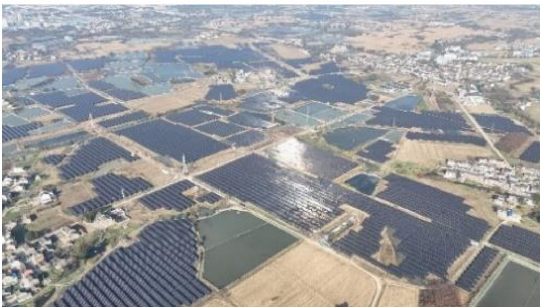
中電江蘇宜興一期太陽能光伏電站
