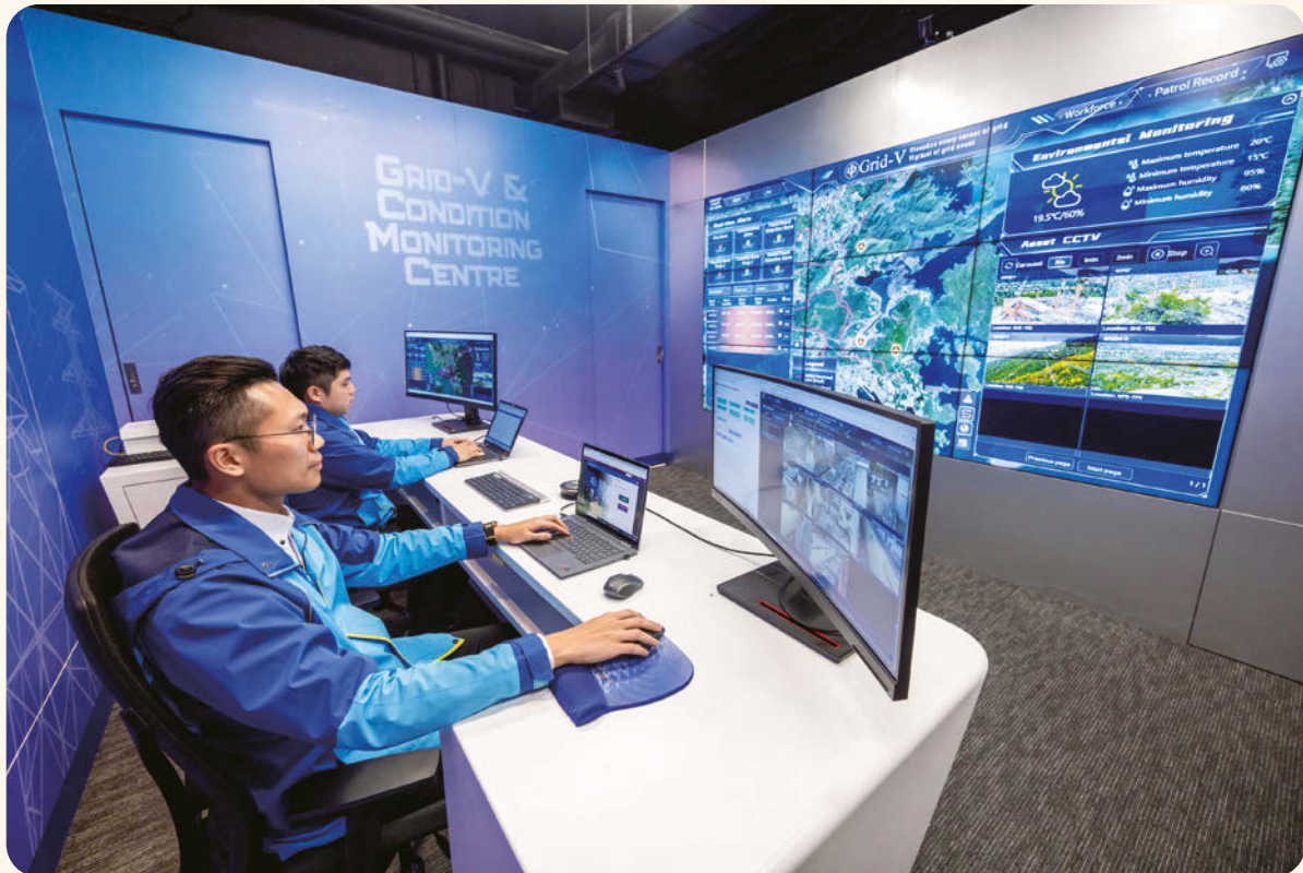
■ 中華電力的Grid-V系統利用人工智能輔助分析來增強對電網的監控。
