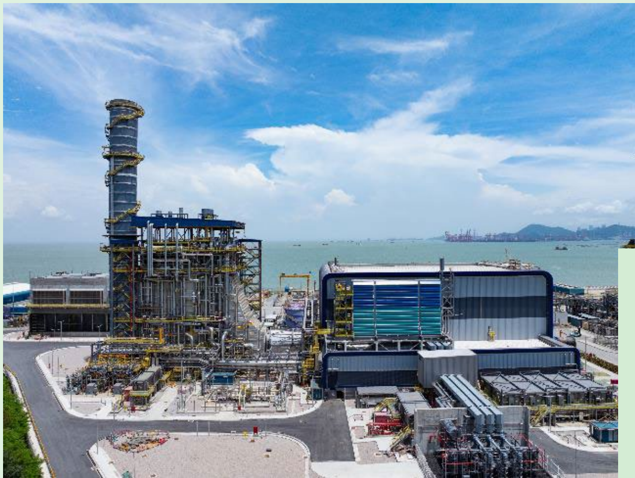
位於香港龍鼓灘發電廠的聯合循環燃氣渦輪發電機組D2。
