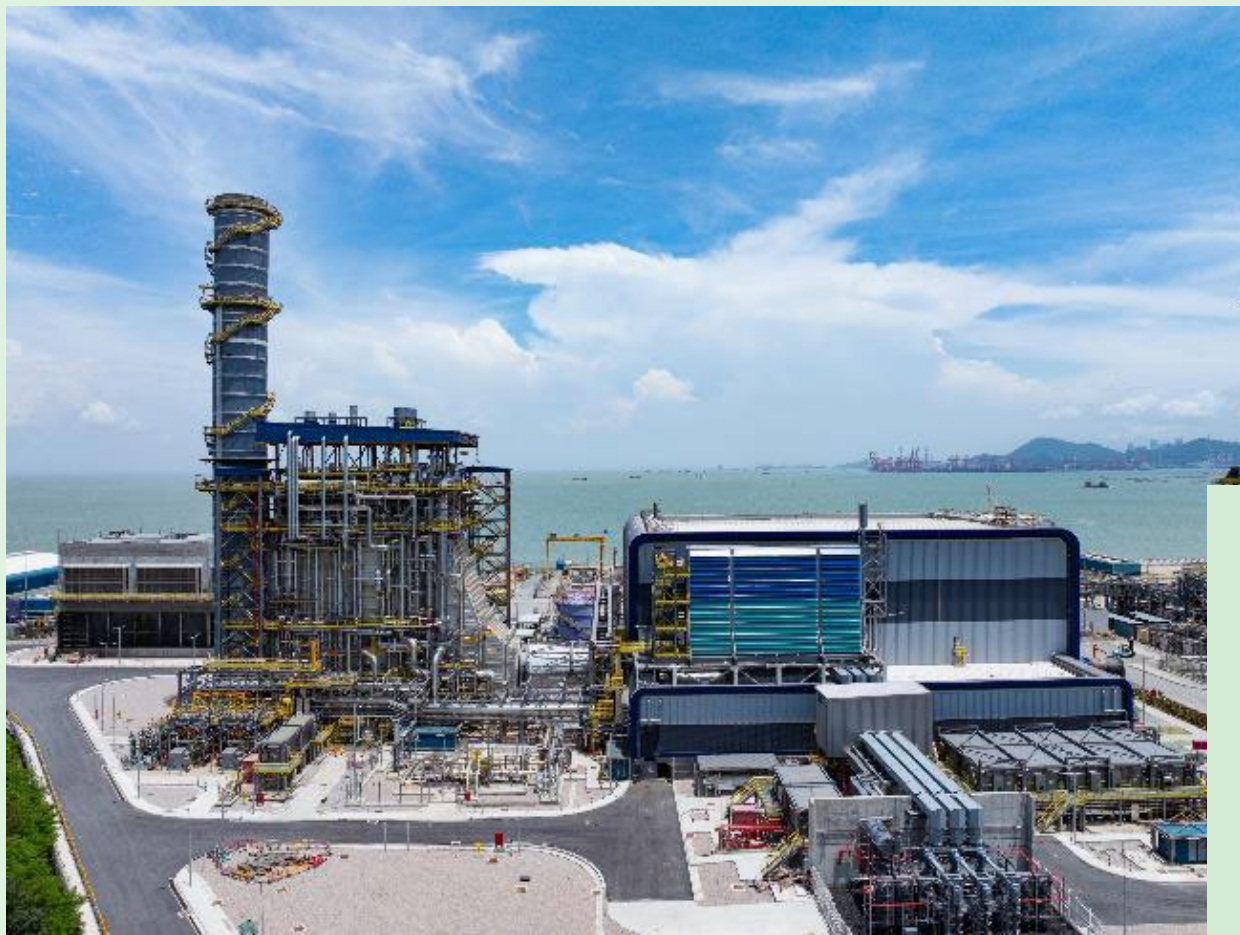
位于香港龙鼓滩发电厂的联合循环燃气涡轮发电机组D2。
